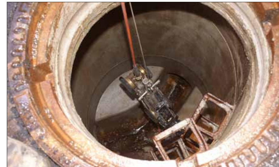
Hinab geht's: Die Kamera wird vorsichtig in den Schacht hinabgelassen. Bis zu 450 Meter kann sie durch die Rohre fahren
