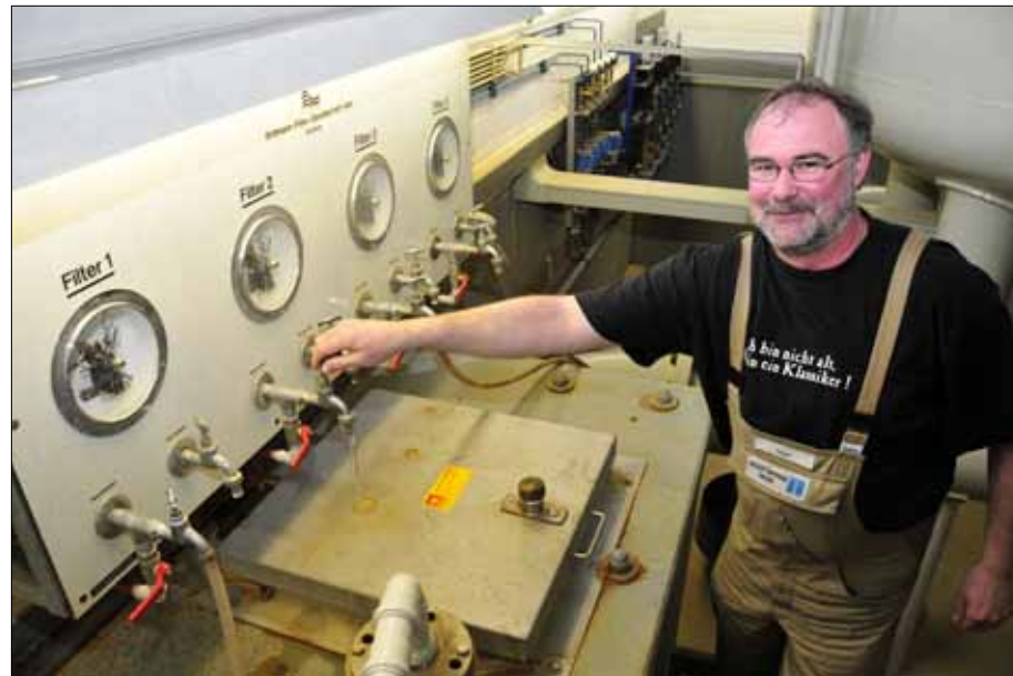
Sorgt für einen reibungslosen Ablauf im Heider Wasserwerk: Jan Nagel
